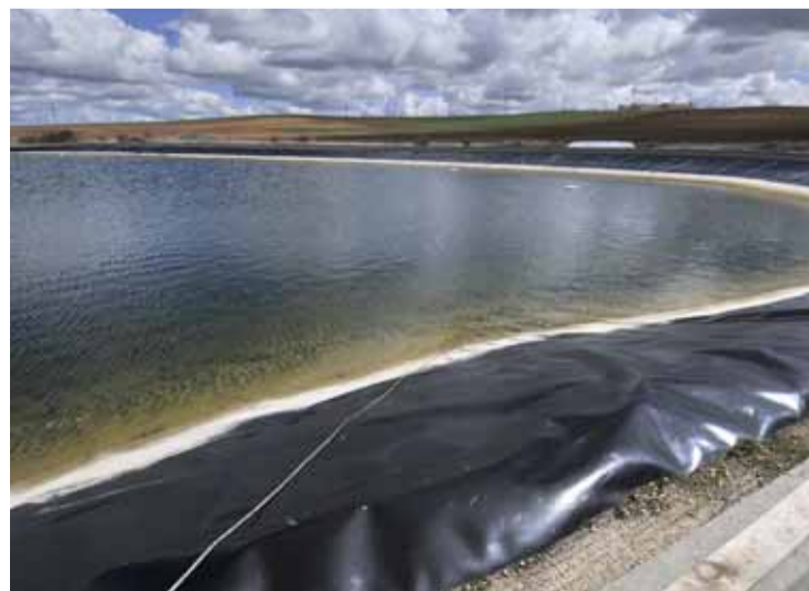
Balsa de agua en el recientemente modernizado Canal de Almazán. / V. G.
